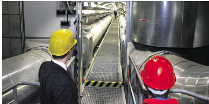
Der Fernwärmehunnel unter Kiel.
